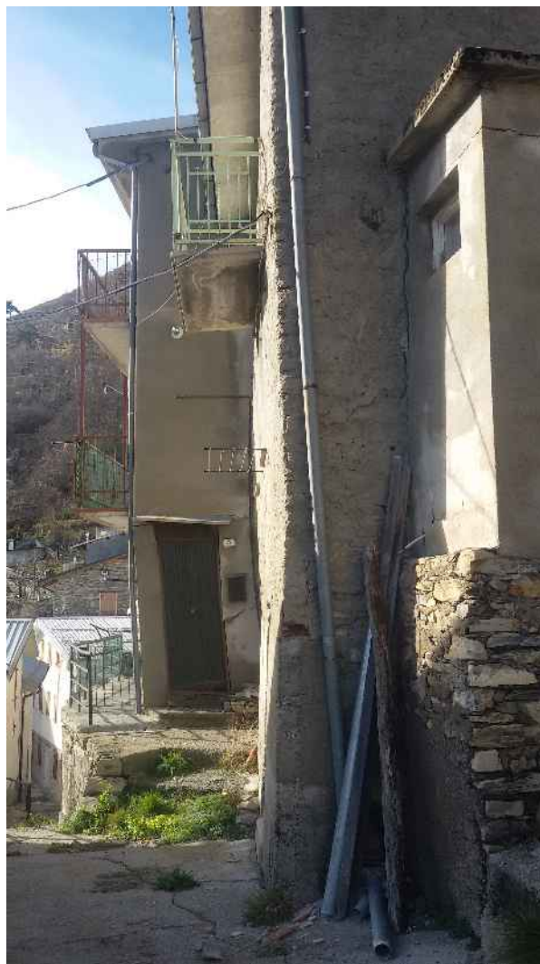
Vista laterale, si noti la deformazione della porta di accesso al piano terreno dell'edificio 2
