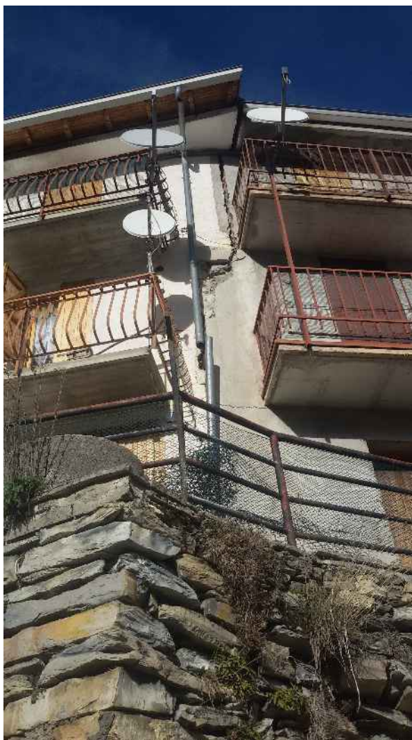
Vista frontale della crepa creatasi in corrispondenza del muro di spina tra edificio 1 e 2
